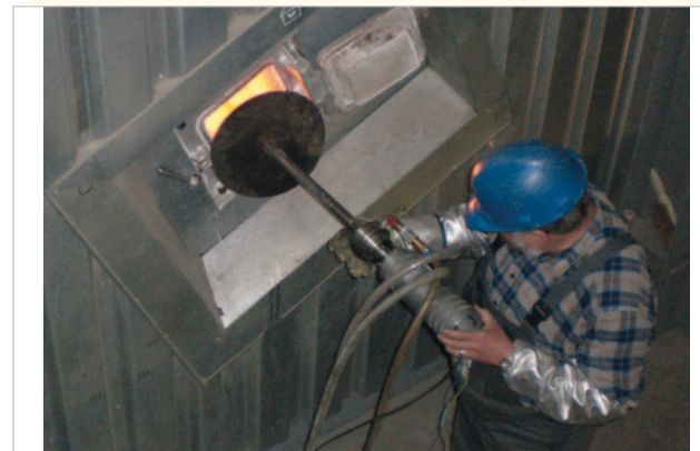
Messeinsatz an einer Brennkammer eines Strahlungskessels
