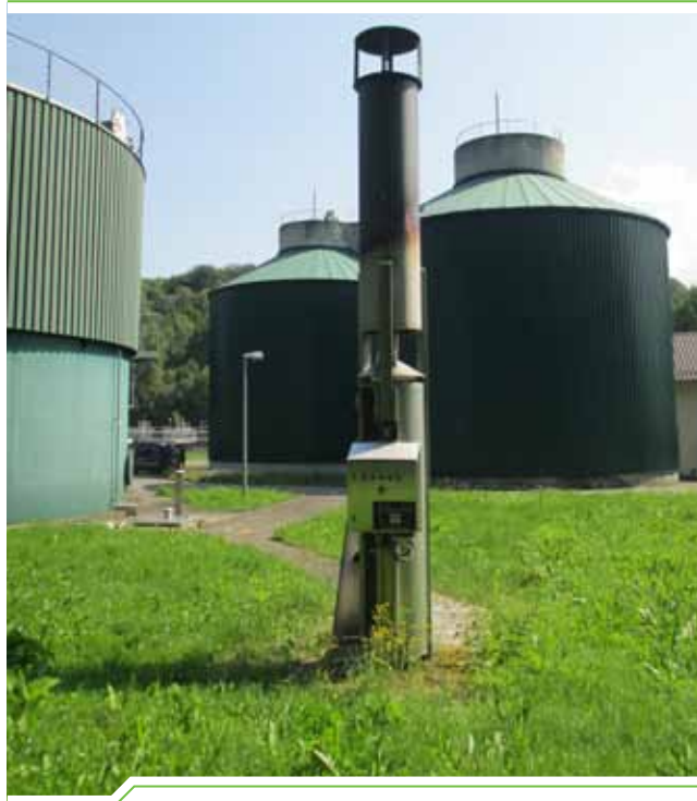
Gasfackel auf einer Kläranlage
