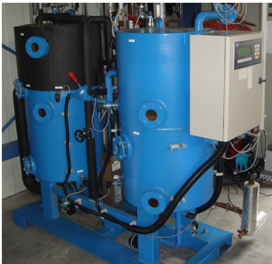
Abbildung 5: Absorptionskälteanlage vom Typ WEGRACAL SE 15
