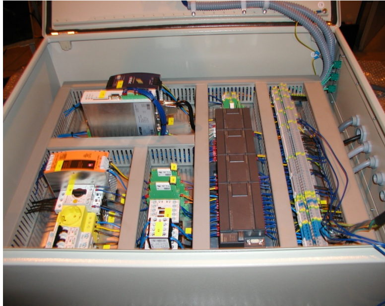
↑ SPS – Schaltschrank (Überwachung, Notrückzug, Bewegung)
